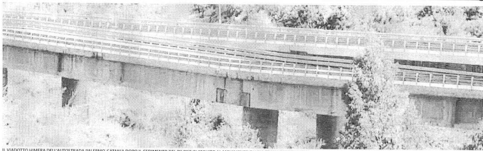
IL VIADOTTO HIMERA DELL'AUTOSTRADA PALERMO-CATANIA DOPO IL CEDIMENTO DEL PILONE IN SEGUITO AL MOVIMENTO DI UNA FRANA SOTTOSTANTE
